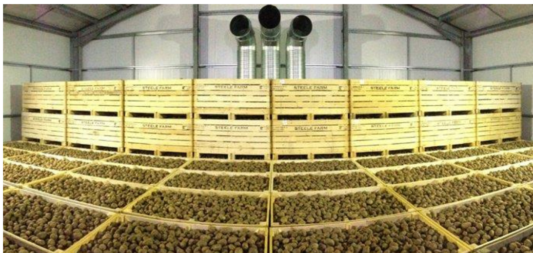
Рис. 5.3. Система активної вентиляції з повітрозмішувальною стіною (зі зворотним потоком повітря) бульб картоплі в контейнерах (джерело: http://4styxhii.com.ua/uk/services-ua/sistemi-zberigannya-ovochiv/ )
