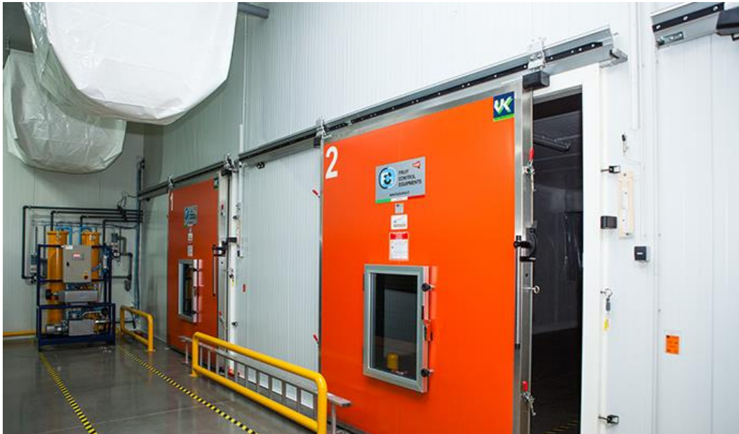
Рис. 3.19. Холодильне обладнання VanKempen
