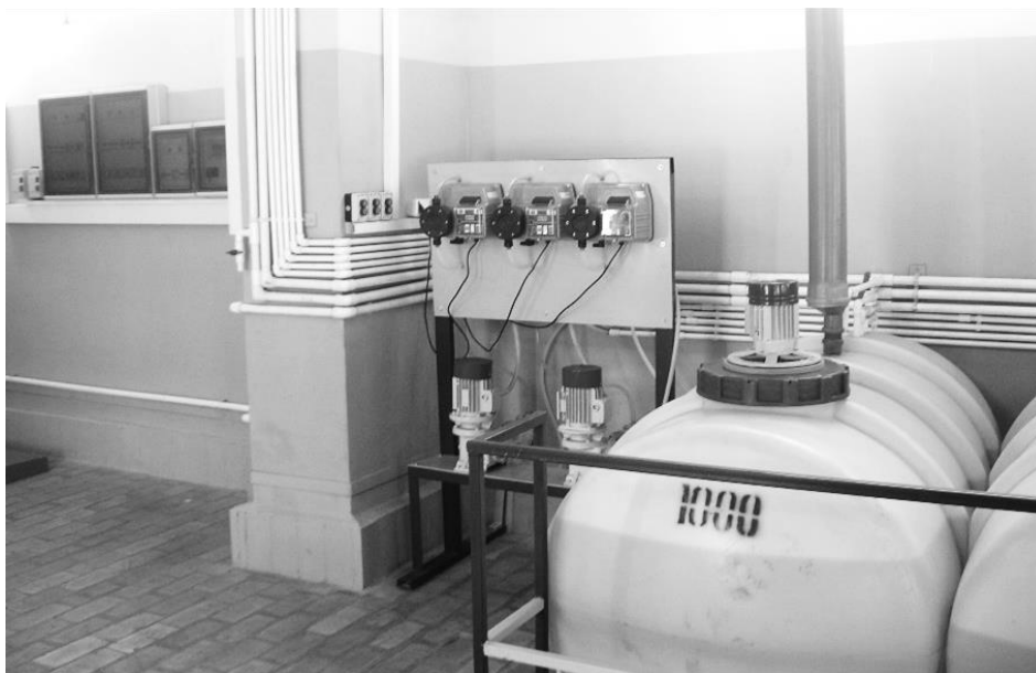
Рис. 7. Комплекс автоматизованого дозування реагентів (промисловий контролер, панель оператора, насоси-дозатори, баки реагентів) на МЗПК(м. Мелітополь). Розробка авторів
