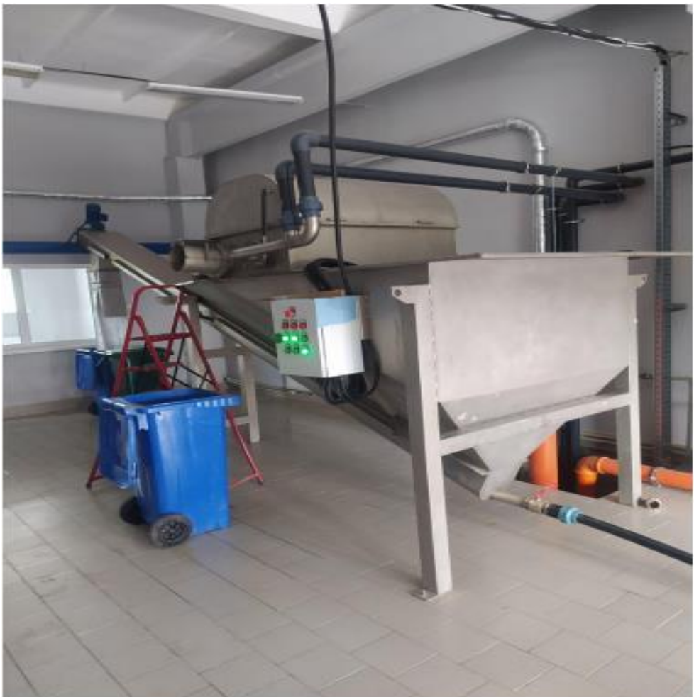
Рис. 2.2 – Реконструйовані очисні споруди м. Бучач
