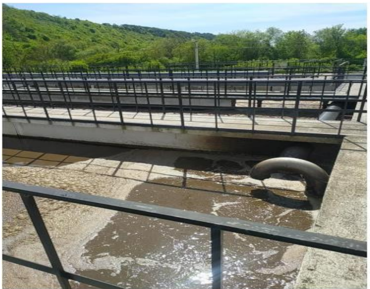
Рис. 2.1 – Реконструйовані очисні споруди м. Чортків
