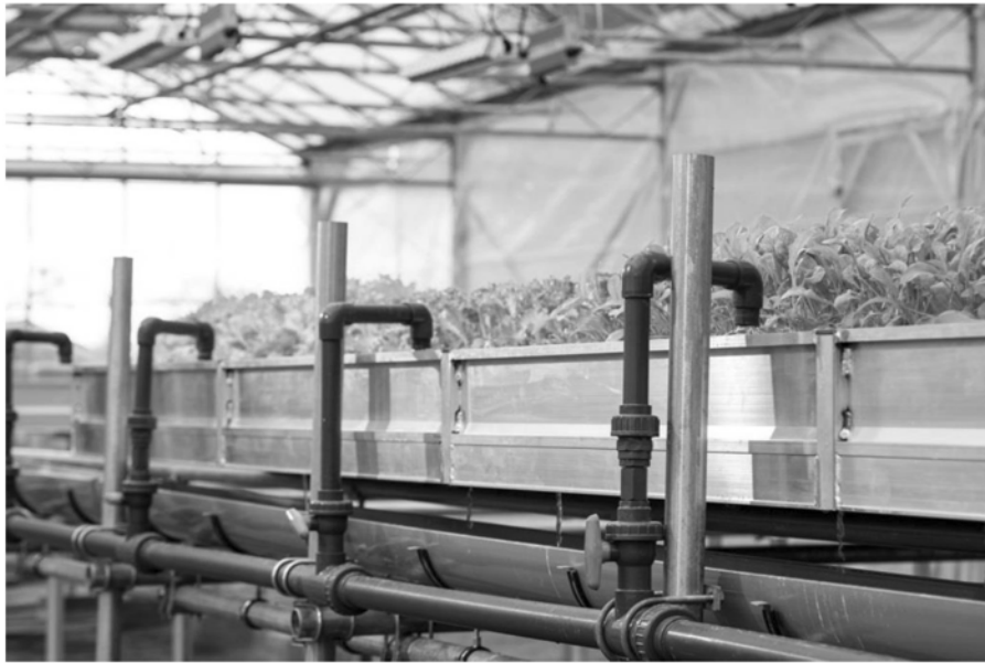
Рис.2.5 Частина магістралі подачі виконана із ПВХ труб.
