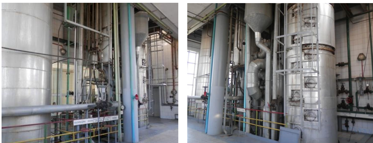
Рис. 2.3 – Нове обладнання для виробництва етилового спирту заводу
