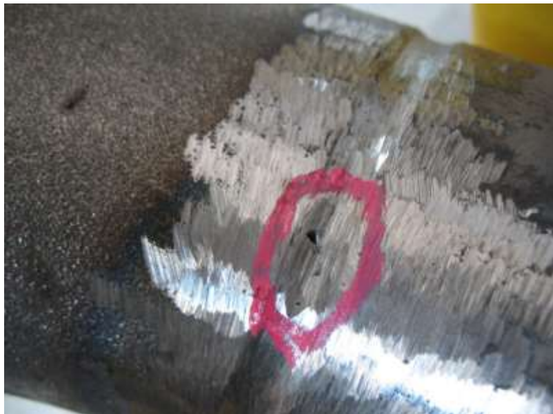
Рисунок 3.8 - Тріщина зварного шва
