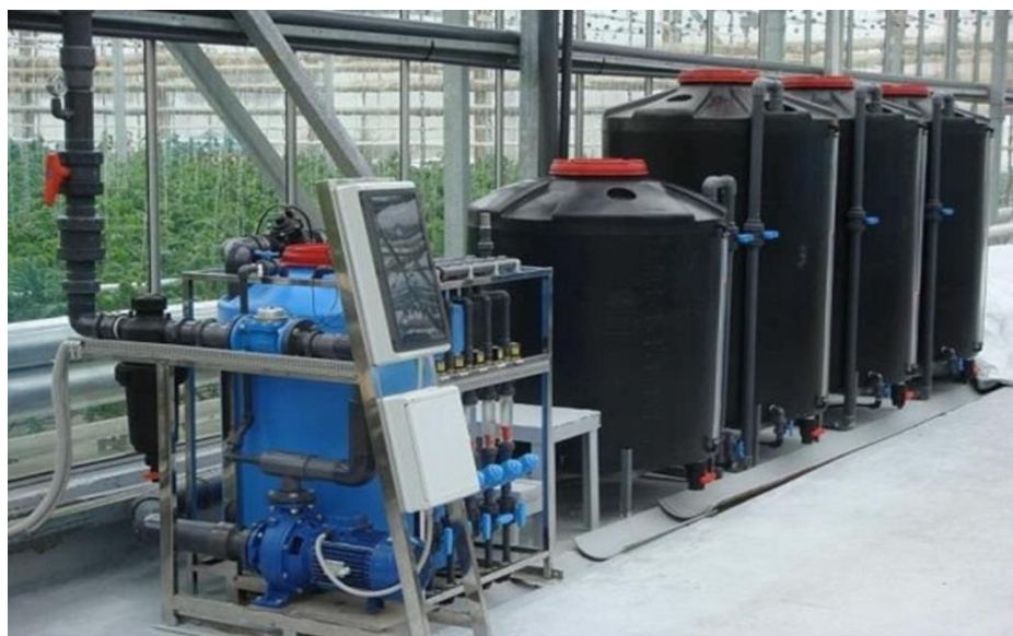
Рис. 1.6 – Автоматизований комплекс підготовки живильного розчину
