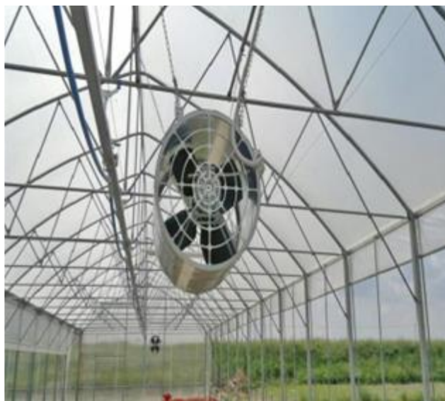
Рис. 1.9 – Вентиляційні фрамуги та тепличний вентилятор
