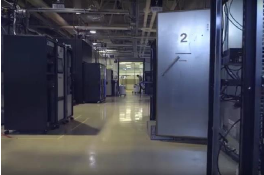
Рис. 4.1. Загальний вигляд залу із квантовими комп'ютерами
