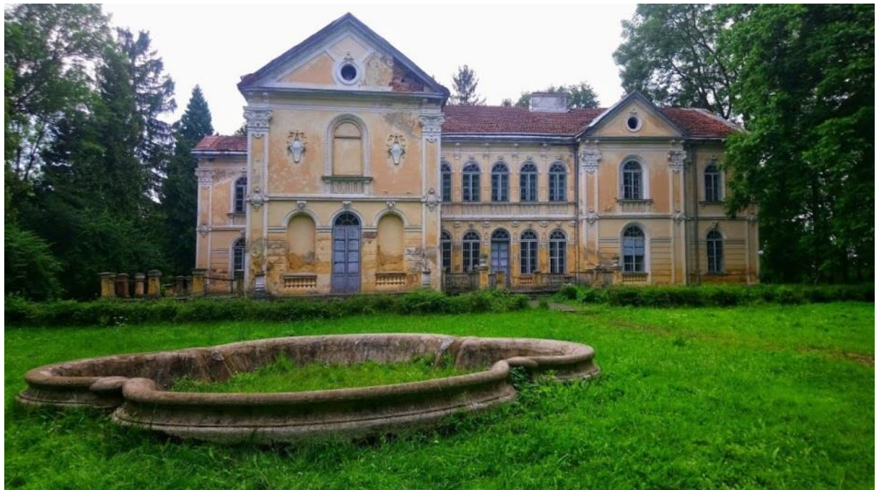
Рис.3.10 - Суттєві пошкодження покрівлі і фасаду.
