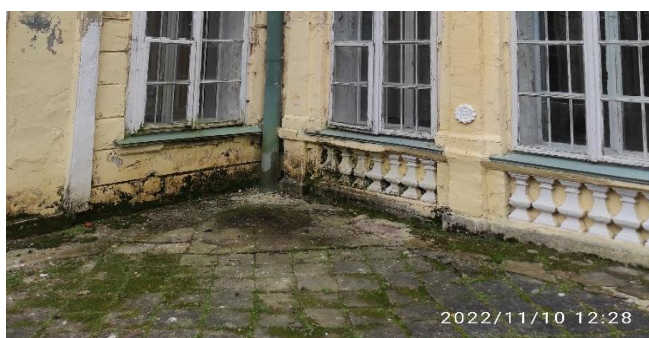
3.1 - Пошкодження вимощення та цоколя будівлі
