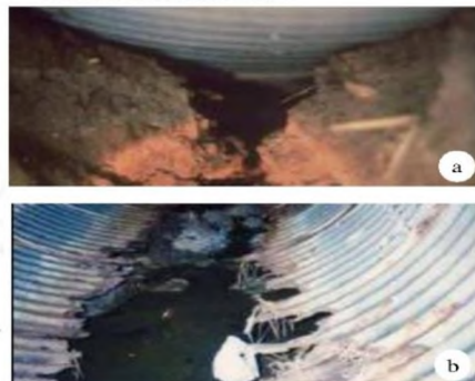
Рис. 5. Вимивання ґрунту з ґрунтового конверта, навколо МГК та наскрізні пошкодження лоткової частини МГК внаслідок абразивного зносу
