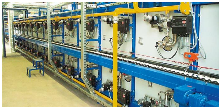
Рисунок 1.2 - Тунельна піч з системою автоматизації
