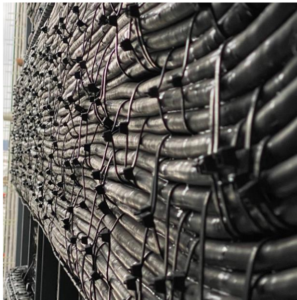
Рисунок 1.4 – Кабельний лоток, заповнений кабелями
