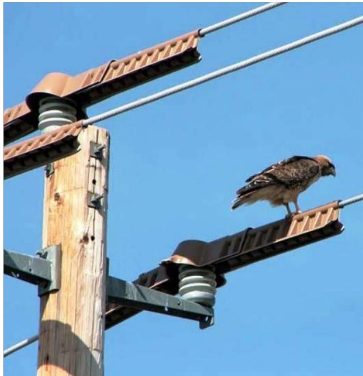
Рисунок 5.3 – Діелектричні кожухи на над ізоляторами дротів ЛЕП
