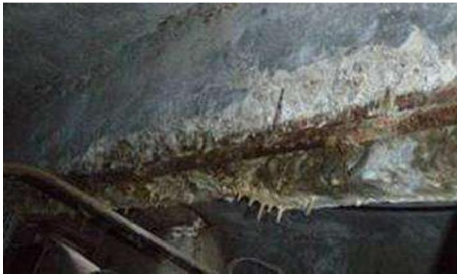
Рис. 6.8. Корозія бетону ригелів (деструкція)
