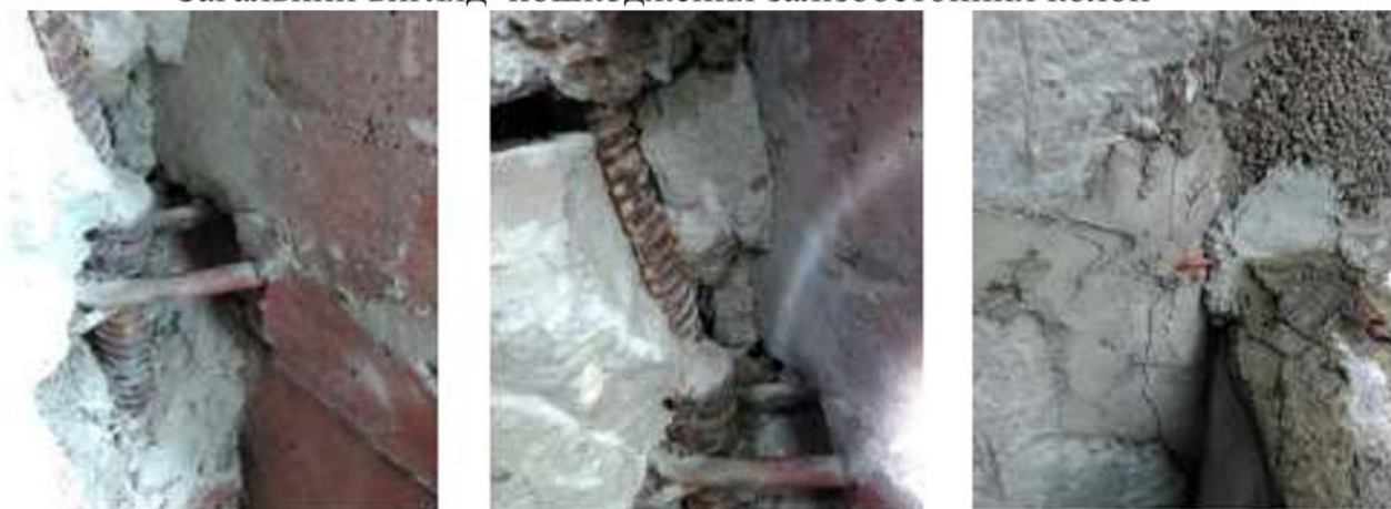
Загальний вигляд пошкодження залізобетонних колон
