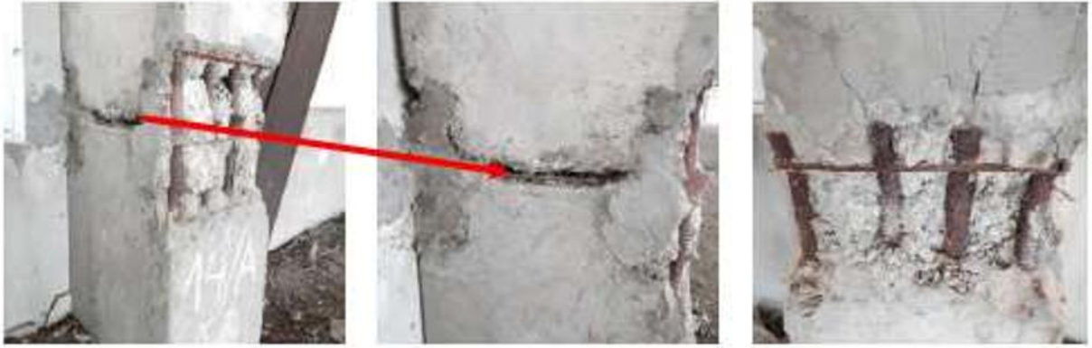
Рис. 6.7. Арматурні випуски у нішах колони вигнуто до напрямку до внутрішньої грані колони, Арматура в стику має поверхневу корозію.
