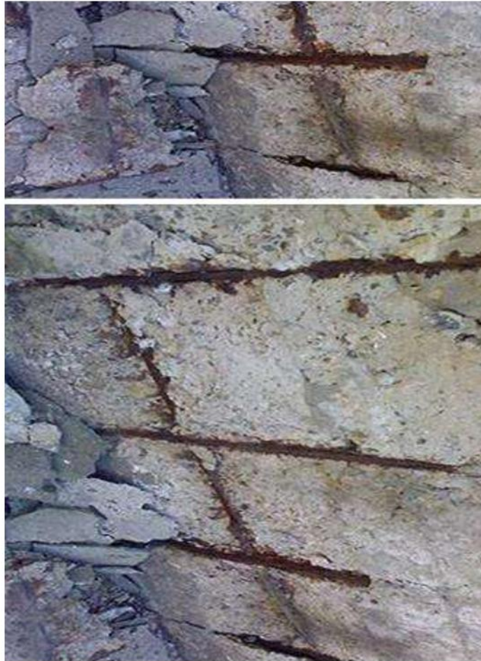
Рис. 6.9. Характерні тріщини на нижній поверхні плити, видимі ознаки значної корозії арматури
