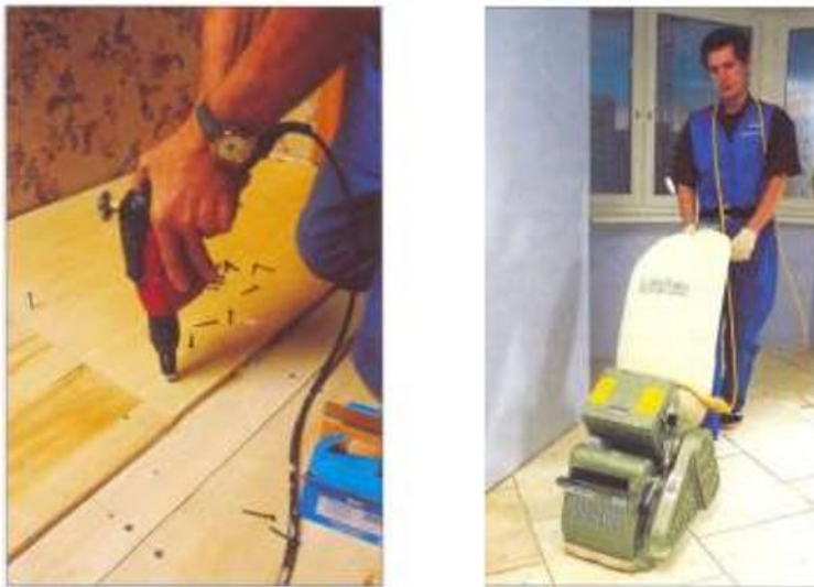
Рис.3.9 Установка фанери за лагами (кріплення другого шару фанери на клей та шурупи) Шліфування фанери за рівнем.
