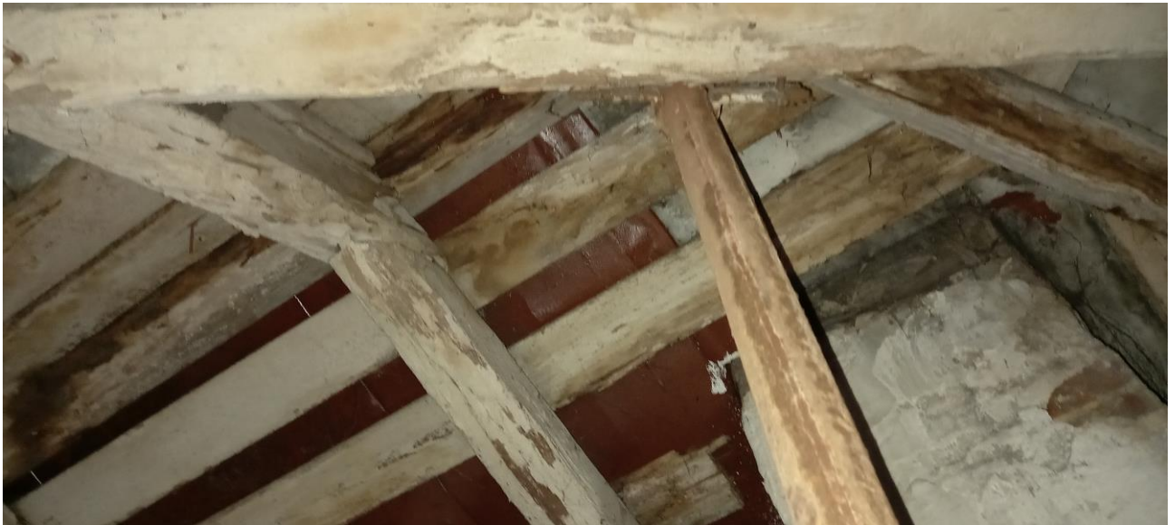
Фото 6.6 Загальний вигляд конструктивних елементів даху (сліди трухлявості, розтріскування, затікання)
