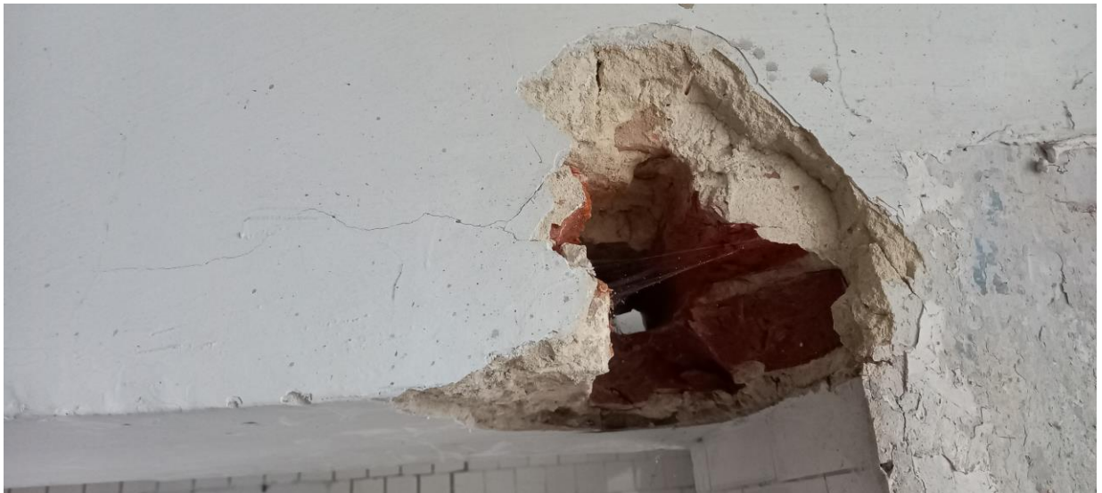
Фото 6.2. Механічні пошкодження цоколю будівлі
