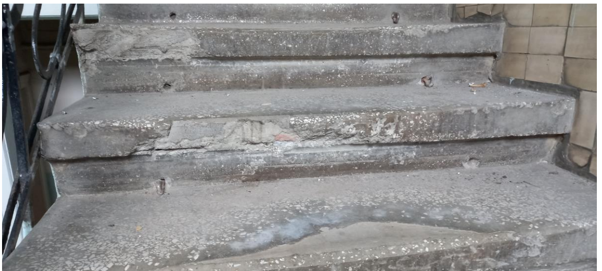
Фото 6.5. Вибоїни на бетонних сходах
