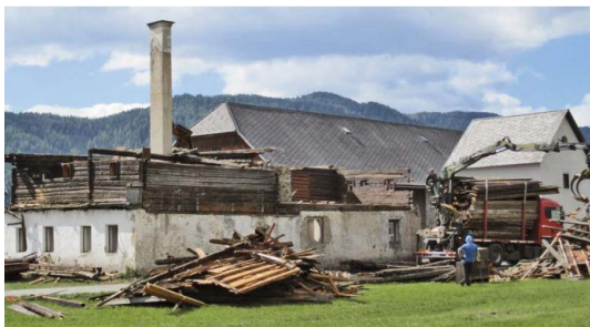
Рис. 2. Знесення так званого «Бургомістерського будинку» у 2012 році. Штирійська Крака називає себе «Гірським селом» – ініціатива, що тісно пов'язана з Альпійською конвенцією
