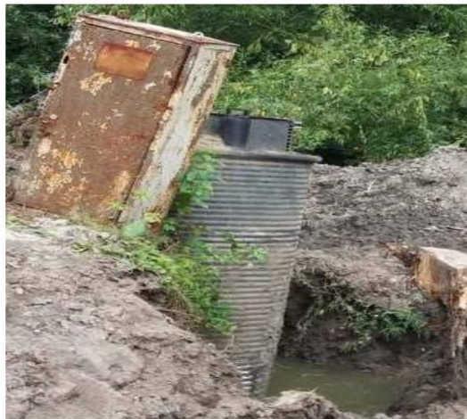
Рис. 2. Каналізаційна насосна станція із корпусом зі спіральньо витих полімерних труб продуктивністю 125 м 3 /добу після одного року експлуатації.
