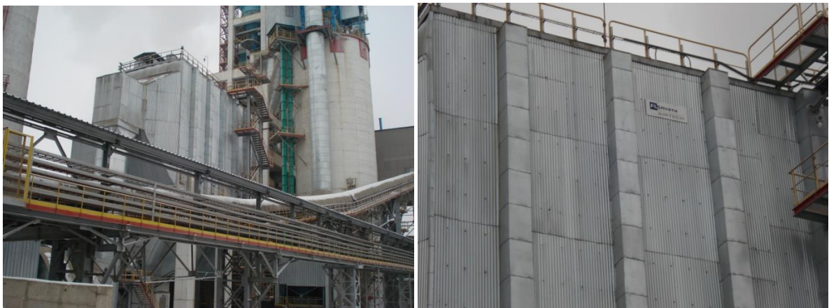
Рис. 4.2 – Установки з електрофільтрами (ПрАТ «Івано-Франківськцемент»)
