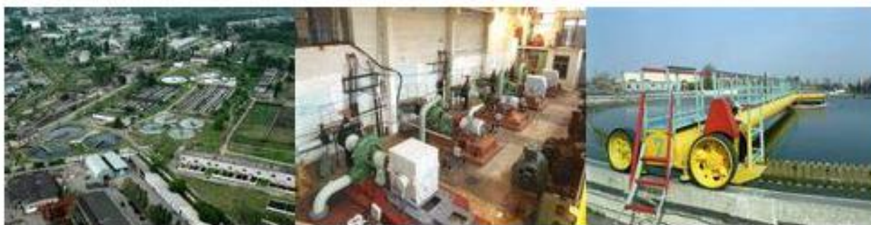
Рисунок 3.9 – Лівобережна станція аерації м. Дніпро
