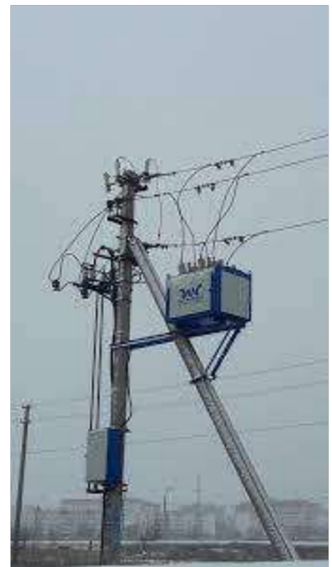
Рисунок 5.2 – Опора ПЛ 10 кВ з КПС
