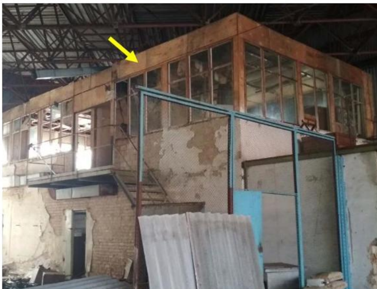
Фото 11. Виробниче приміщення №1 з антрисолою в об'ємі ангару.
