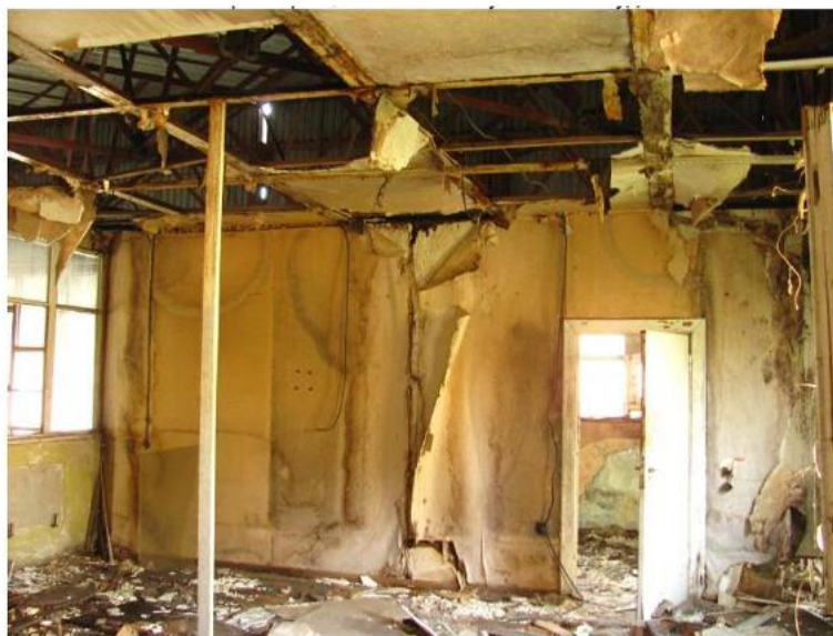
Фото 20. Приміщення в антрисолях. Сліди замкання конструкцій та руйнування елементів приміщень, наявність побутового та будівельного сміття.
