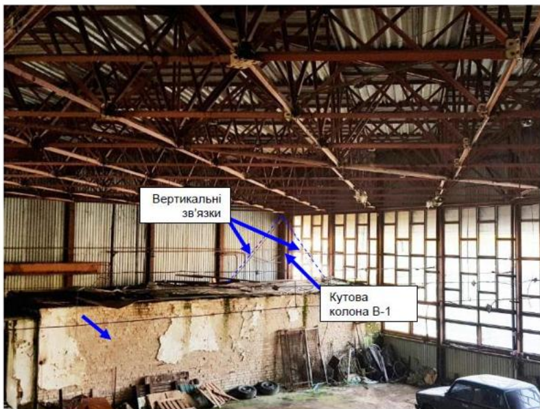
Фото 14 Просторова конструкція перекриття з плоских ферм розміщених під кутом 45^{\circ} і об'єднаних в просторові блоки 15 \times 15 м.
