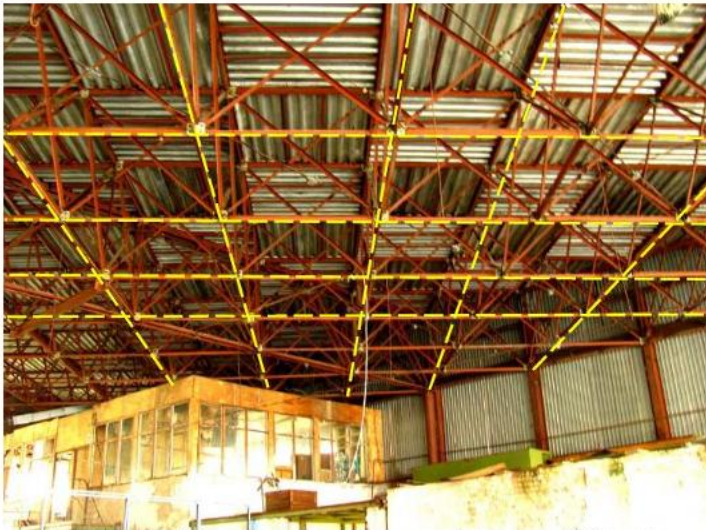
Фото 36. Плоскі діагональні ферми з кроком між фермами 2121мм. По верхньому поясу між фермами встановлені профільовані листи 2121x2121мм
