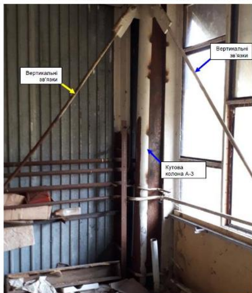
Фото 27. Вертикальні зв'язки з ст.кр. Ø20мм. Розміщуються по чотирьох кутах каркасу будівлі ангару.
