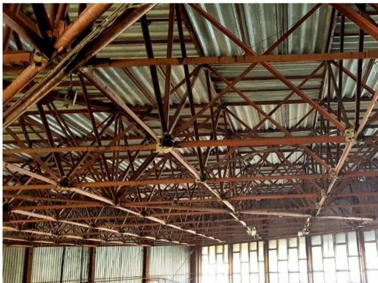
Фото 34. Плоскі діагональні ферми з кроком між фермами 2121мм. Оббирання ферм на фахверкові стійки з кроком 3м
