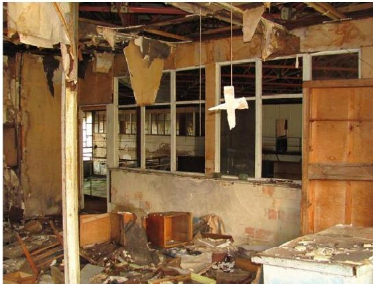
Фото 19. Приміщення в антрисолях. Сліди замкання конструкцій та руйнування елементів приміщень, наявність побутового та будівельного сміття.
