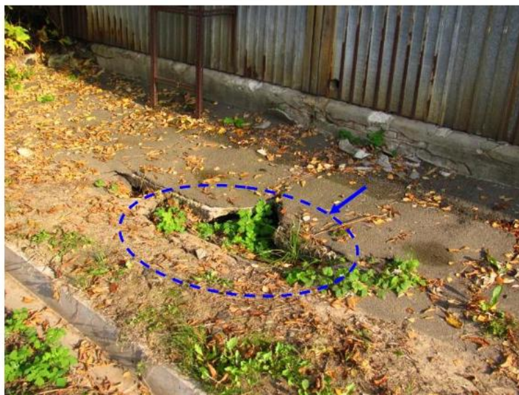
Фото 7. Руїнування відмостки будівлі.
