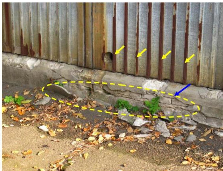
Фото 6. Сліди замкнення цоколя, відшарування тиньку. Поверхнева корозія сталевих профільованих листів.
