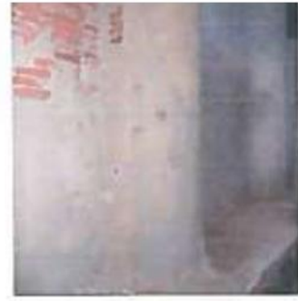
Рис 6.2. Руйнування штукатурного шару на зовнішній стіні. Замокання
