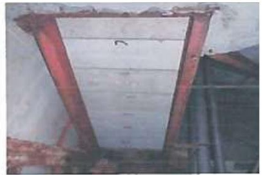
Рис. 6.6. Корозія елементів сталевому, механічні пошкодження залізобетонної площадки сходової клітки.
