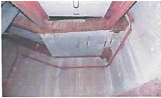
Рис. 6.1. Корозія елементів сталевому каркасу та арматури сходової площини сходової клітки
