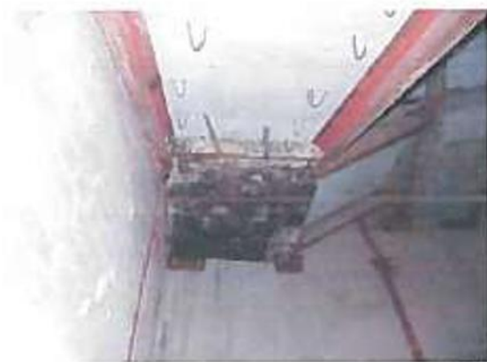
Рис. 6.13. Корозія елементів сталевго каркасу сходової клітки
