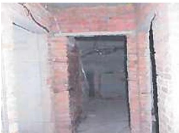
Рис. 6.15. Неякісне заповнення швів цегляної кладки
