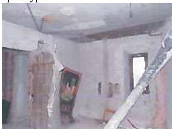
Рис. 6.18. Механічні пошкодження на ділянках стін
