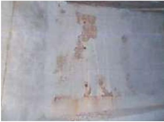
Рис. 6.19. Руйнування штукатурного шару, корозія металевої сітки
