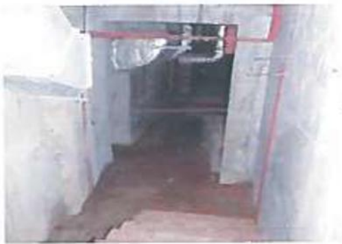
Рис 6.3. Сліди замокання на ділянці підлоги
