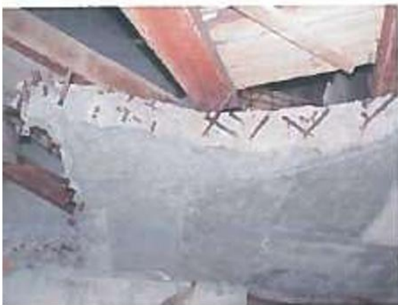
Рис. 6.21. Механічні пошкодження площадки сходової клітки
