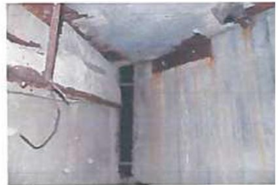
Рис 6.4. Корозія сталевих елементів закладних деталей
