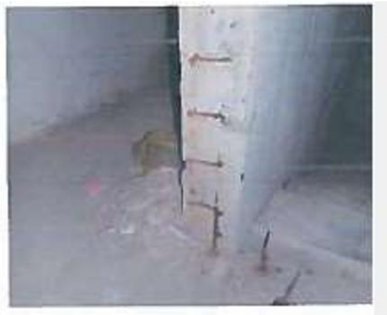
Рис. 6.22. Недостатній захисний шар бетону на ділянці стіни, оголення і корозія.
