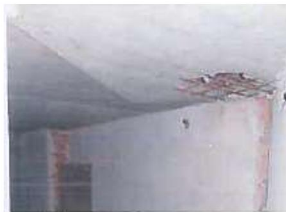
Рис. 6.16. Механічні пошкодження на ділянках перекриття, корозія арматури.
