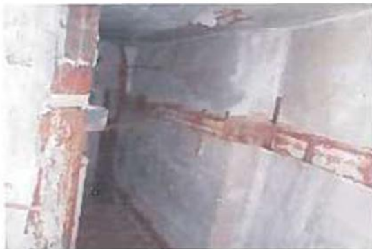
Рис. 6.5. Корозія сталевих конструкцій, механічні пошкодження на ділянці перекриття, корозія арматури Неякісне виконання зварних швів
