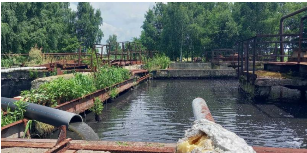
Світлина 2.1 Каналізаційні очисні споруди
