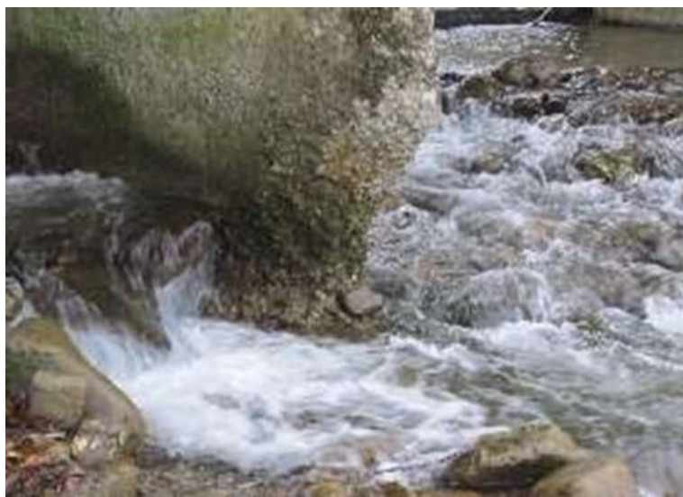
Рис. 3.34. Кавітаційна ерозія бетонної опори моста через р. Кам'янка [163]
