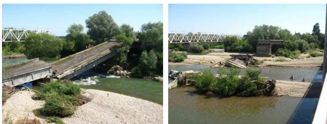
Рис. 1.13. Зруйнований міст за повені на річці у м. Стрий
