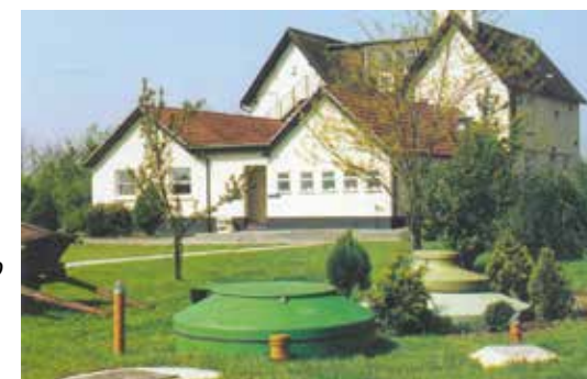
Рис. 4.22. Приватна установка біологічного очищення стічних вод
